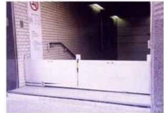
雨水流入防止 (仙台市)
